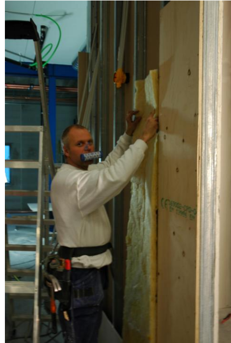
Figur 11. Isolering, postterminalen Fläskebo.
